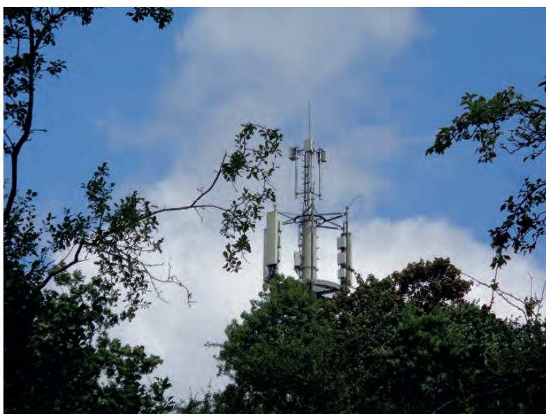
Antennes-relais des réseaux de communication mobile. Les antennes supérieures sont des antennes 5G qui émettent dans la bande de fréquence 3,6 GHz
